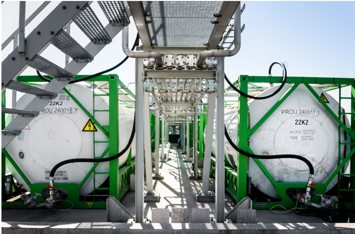
Lagertankar vid anläggningen i Vargön.
